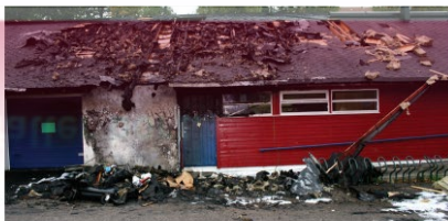
Aktivitetssenter for ungdom i Oslo, brann i avfallsbeholder plassert inntil yttervegg. Foto: Norsk brannvernforening, Thor St. Adolphsen
